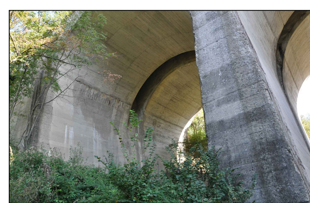
ARCHI Difetto: percolamento con cls. ammalorato e distaccato con tratti di armatura scoperta e fortemente corrosa (VOTO 43) Intervento: Ripristino superficiale archi
