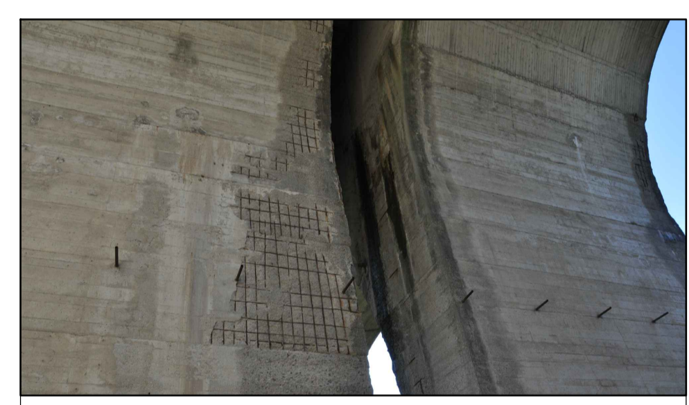
PILE - ELEVAZIONI Difetto: percolamenti con cls. ammalorato o distaccato e armatura scoperta e localmente staccata dal supporto e fortemente corrosa (VOTO 43) Intervento: Ripristino spigoli pile.
