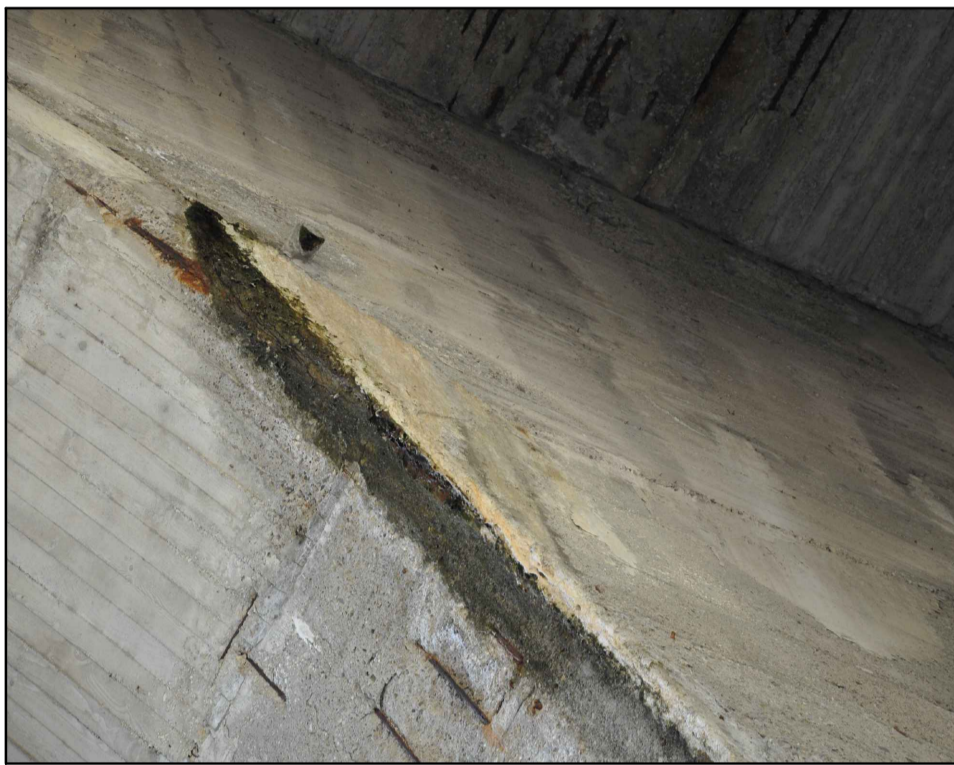
SMALTIMENTO ACQUE Difetto: assente o fortemente degradato Intervento: Ripristino completo
