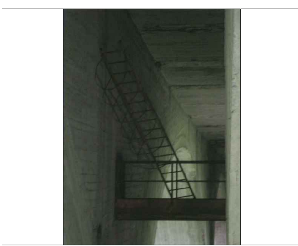
SCALETTE DI ISPEZIONE Difetto: struttura in dissesto non adoperabile Intervento: Ripristino completo
